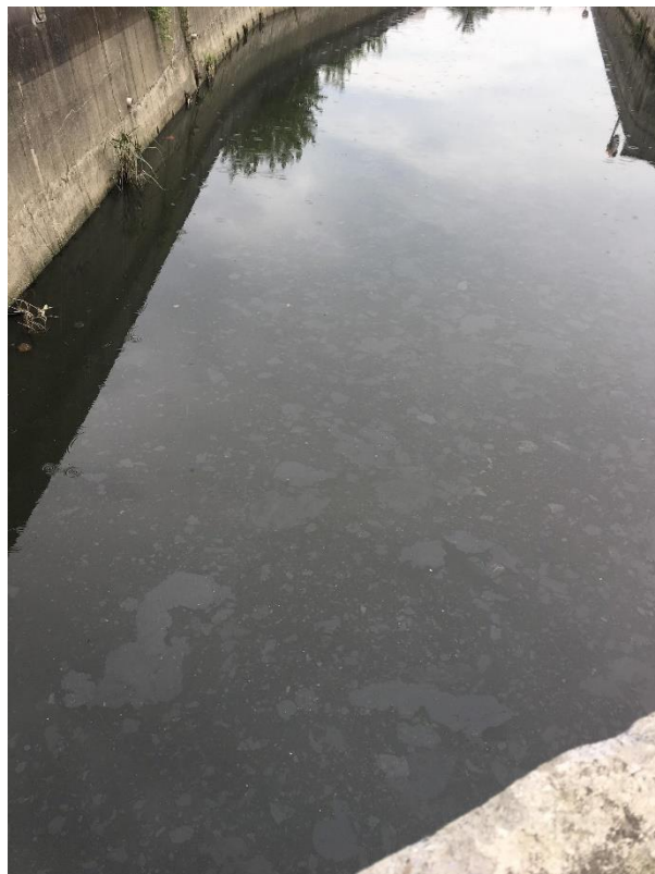
圖 1-1 排水線上方常有油污漂浮
